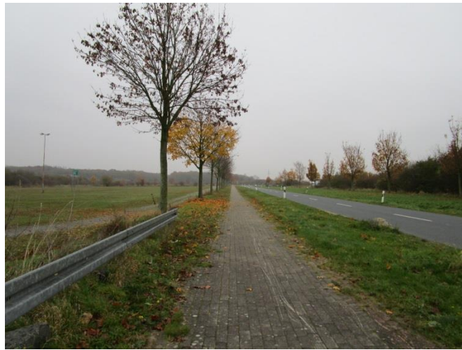
Abb. 4.7: Radweg mit Belagsmängeln
